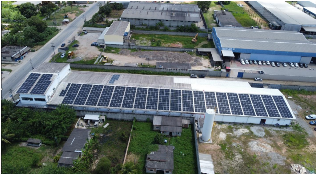
Figura 8 Painéis fotovoltaicos da BordTex
